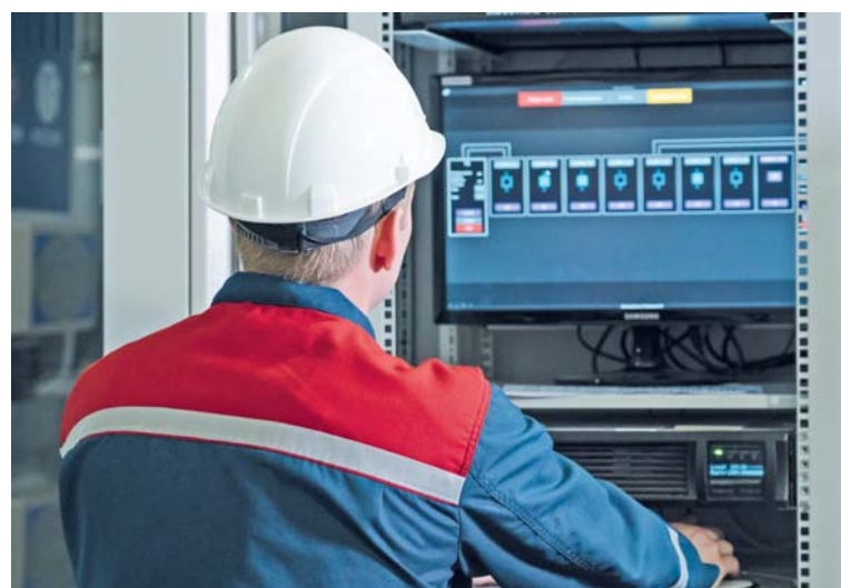
Шкаф автоматизированного рабочего места Системы мониторинга трансформаторов и КРУЭ ПС Медведевская, данные из которого передаются в SCADA-систему на АРМ дежурного ПС
